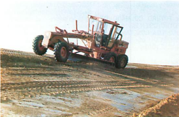
Ampliación de caminos vecinales de Lepe con motivo de las obras de la zona regable del Chanza
