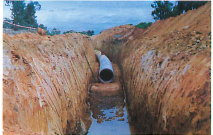
Instalación de conducciones de abastecimiento a los sectores 8, 9, 10 y 11 de la zona regable del Chanza.
