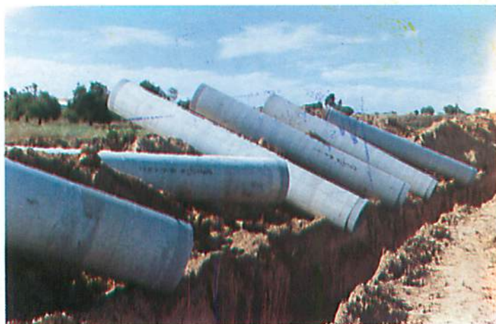
Conducción de reparto del agua a las distintas parcelas del sector 8
