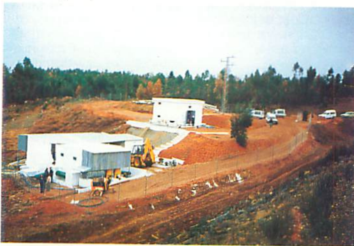
Panorámica general de la estación de bombeo del riego en precario de la Comunidad de Regantes de Lepe
