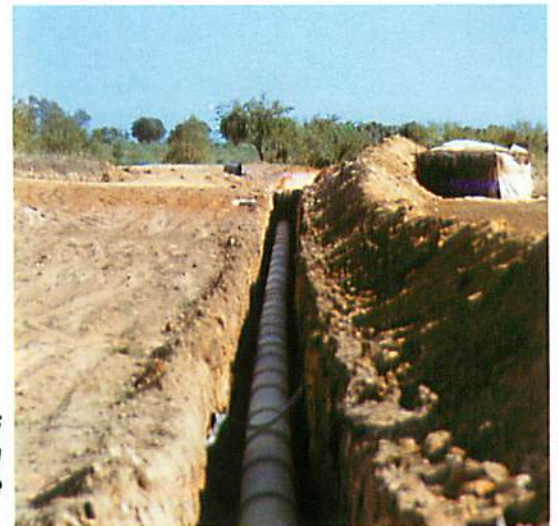
Conducciones de distribución del sector nueve
