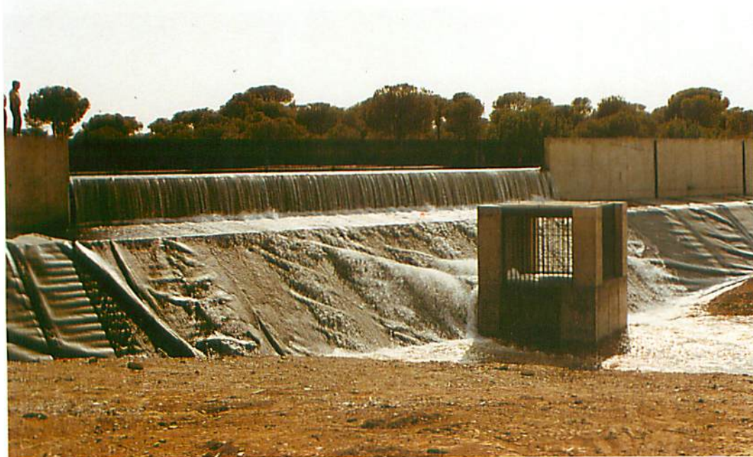
Toma en el Canal para la parte oeste de la Zona Regable del Chanza
