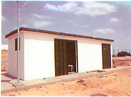
Centro de transformación eléctrica
