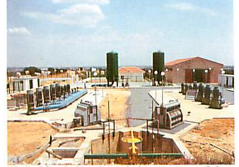
Estación de bombeo de los sectores 8-9
