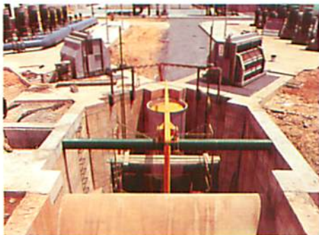
Arqueta de llegada del agua a la estación de bombeo y filtros de partículas gruesas
