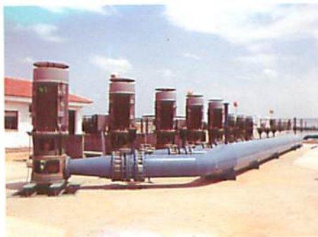
Bombas de impulsión
